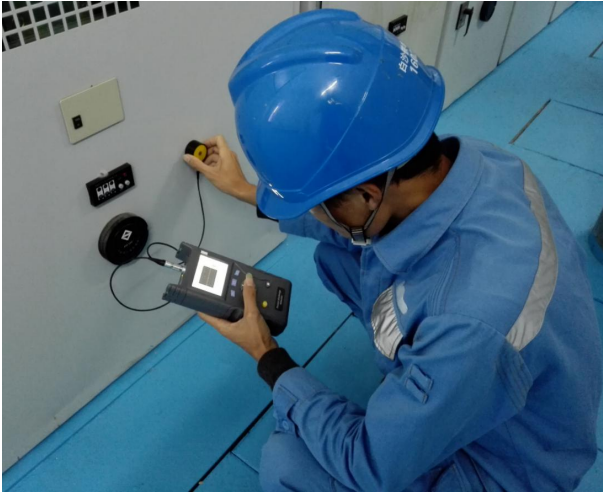
图六 开关柜局放测量
